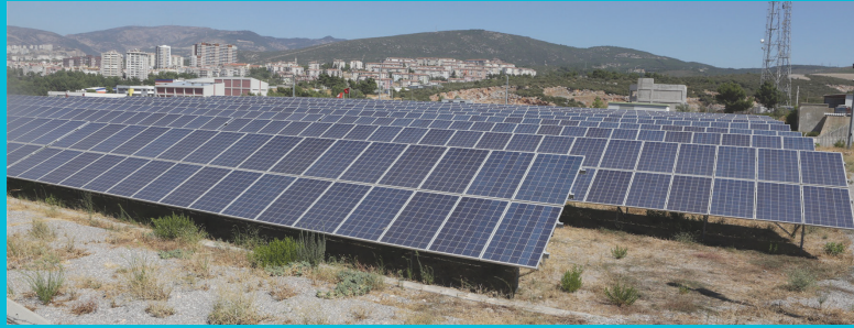
Şekil 2.3. Bornova Belediyesi Güneş Enerjisi Santrali Kaynak: Bornova Belediyesi 25
